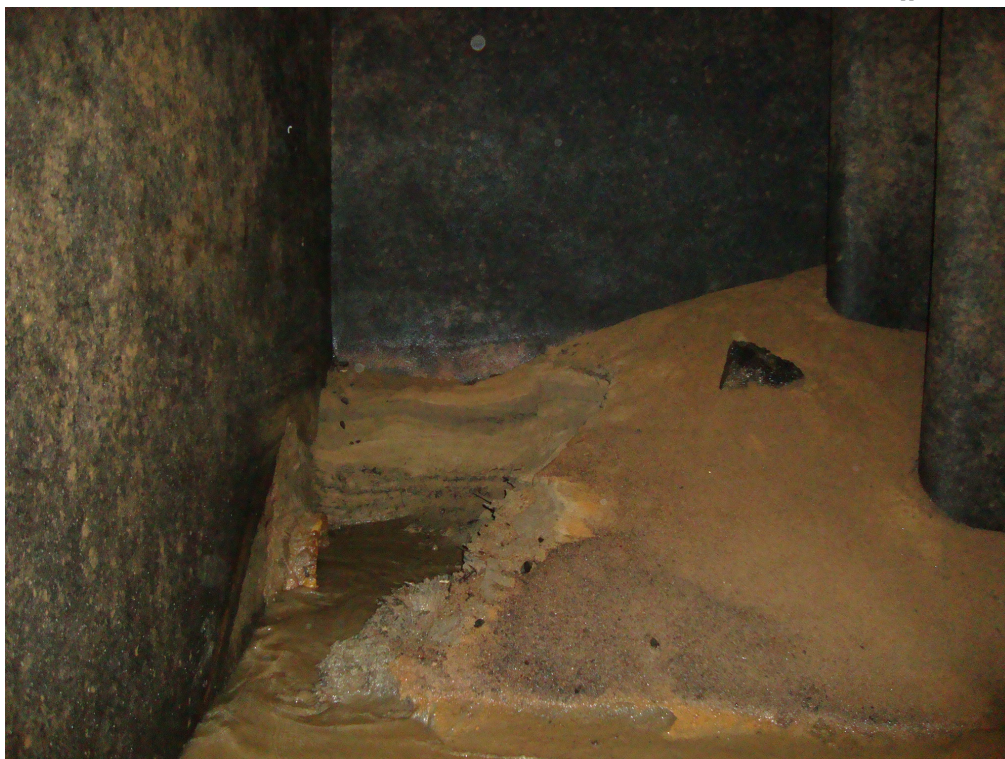
Fig.12 SEDIMENTOS ENCONTRADOS NA GALERIA
