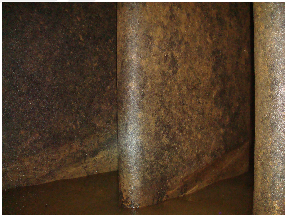
Fig.23- Checagem nas anteparas onde foram encontrados sedimentos.
