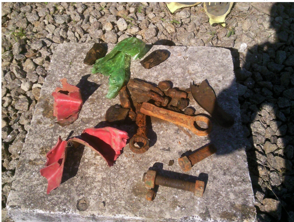
Fig. 6 Alguns detritos encontrados no crivo das bombas e ferramentas encontradas nos poços de sucção.
