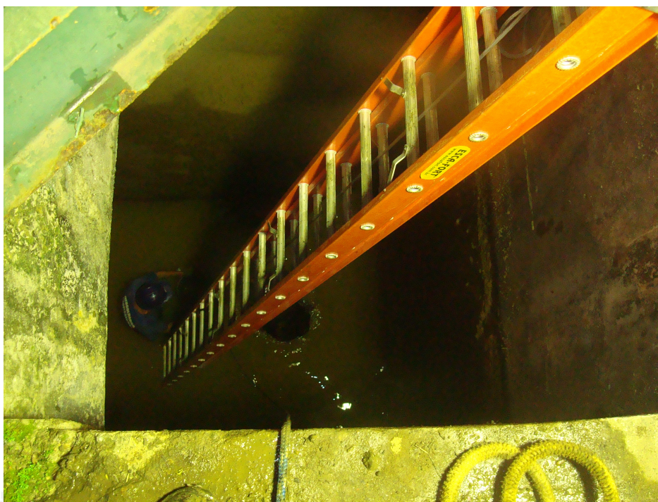
Fig. 18- Escada de acesso e iluminação aos poços de sucção.
