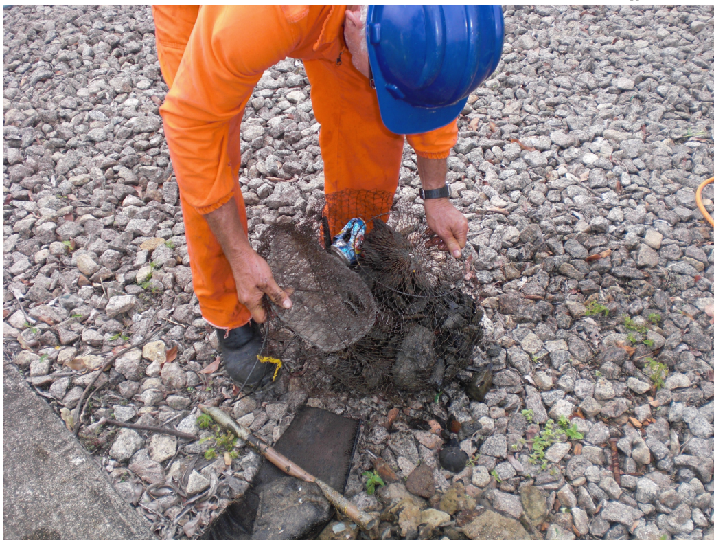
Fig.14 PEDRAS E REBOCOS OBSTRUINDO A DRAGAGEM.
