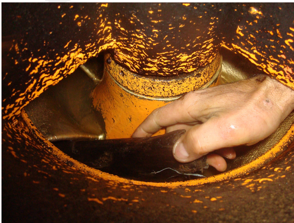
Fig. 21- Pedaco de madeira sendo retirado do crivo da bomba de sucção.
