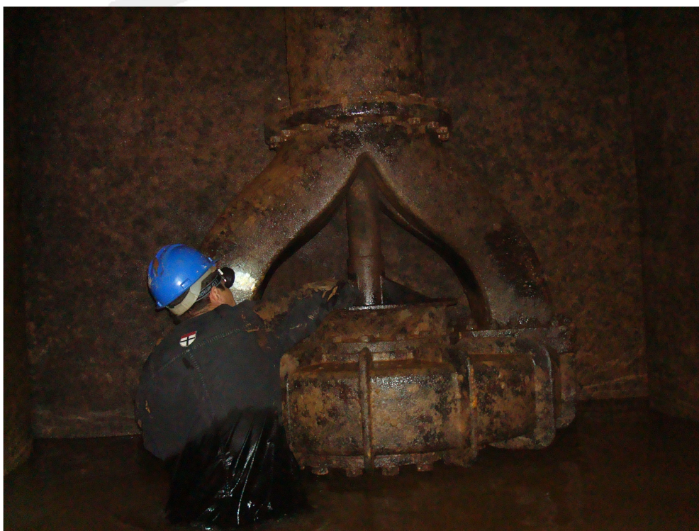
Fig. 19- Checagem nos crivos das bombas para retirada de detritos.
