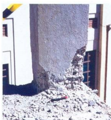
Vazio de concretagem
