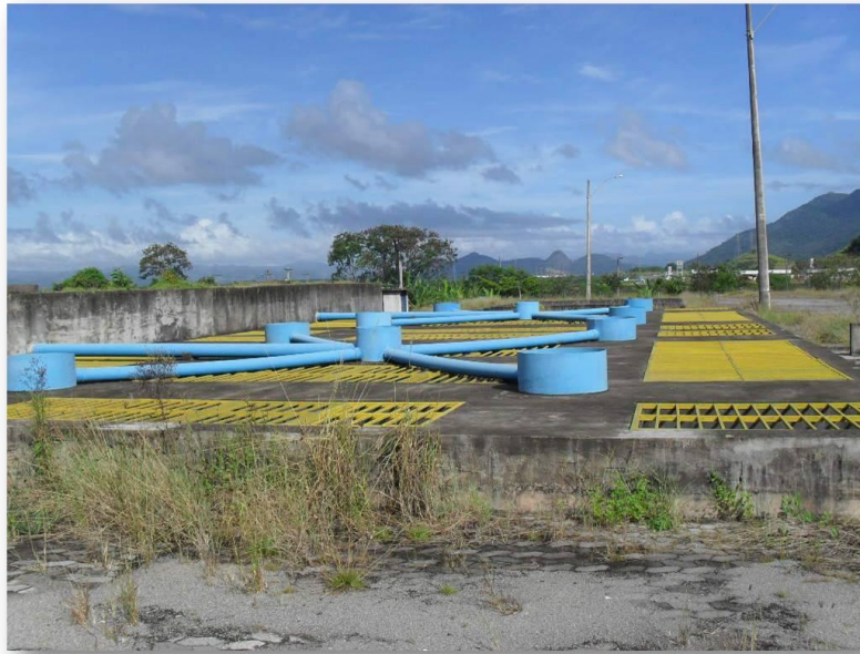
Figura 25 - Visão geral do ETE Jardim Carapina
