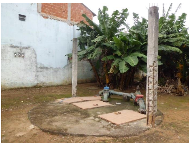
Figura 20: Estação elevatória Rio Marinho
