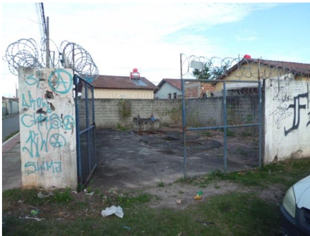
Figura 12: Estação elevatória Jabaeté III
