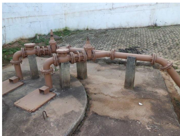
Figura 9: Estação elevatória de Ewerton Montenegro
