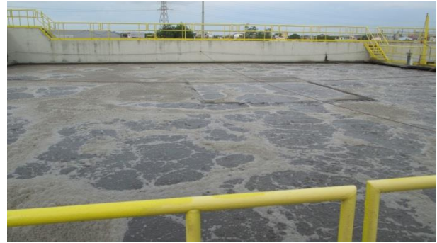
Figura 30: Processo biológico - tanque aeração/decantação 1 (aerando)
