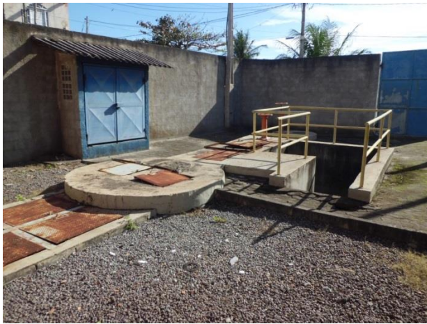
Figura 14: Estação elevatória João Goulart I
