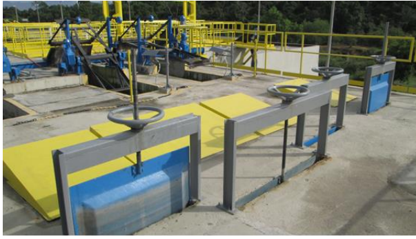
Figura 27: Tratamento preliminar - gradeamento
