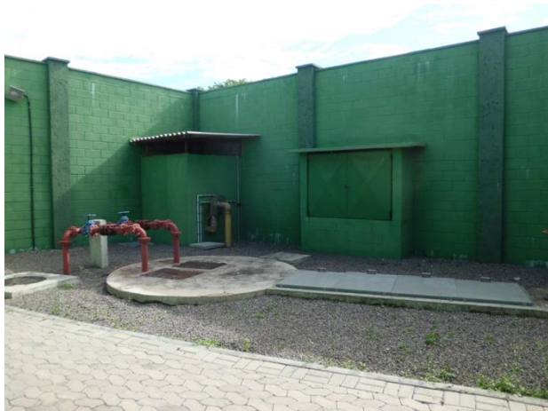
Figura 22: Estação elevatória Riviera Park 1
