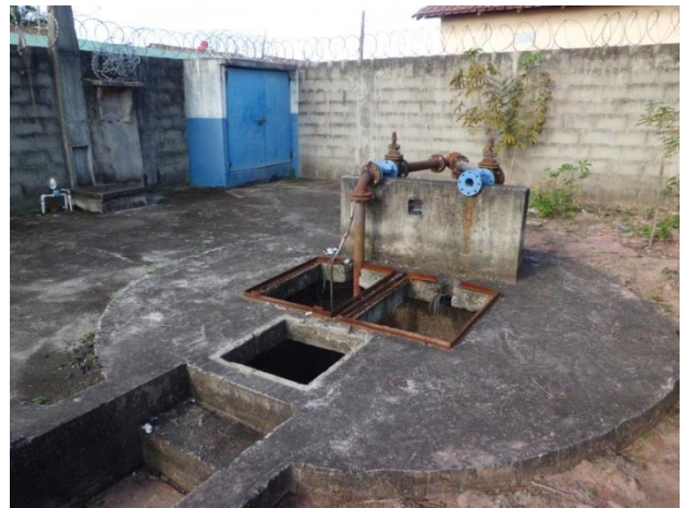
Figura 13: Estação elevatória Jabaeté III
