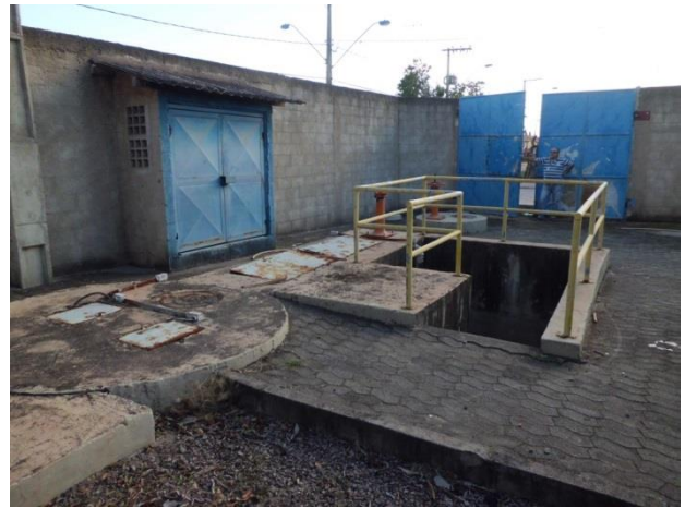
Figura 15: Estação elevatória João Goulart II
