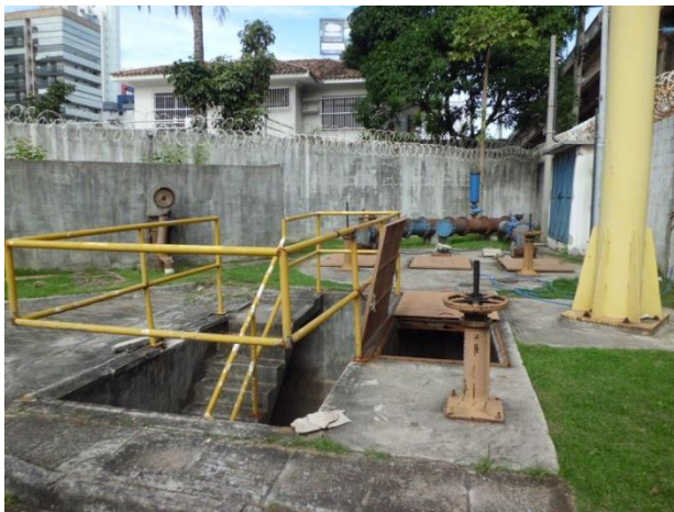
Figura 4: Estação elevatória VVC
