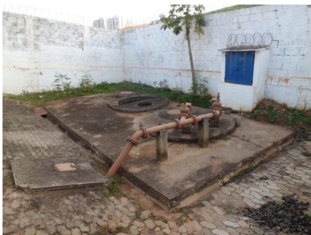
Figura 8: Estação elevatória de Ewerton Montenegro
