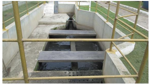
Figura 39: Tratamento preliminar - caixa de areia e calha parshall
