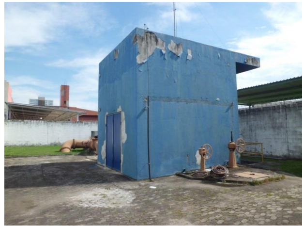
Figura 3: Estação elevatória VVJ
