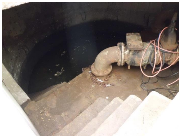
Figura 19: Estação elevatória Vale Encantado
