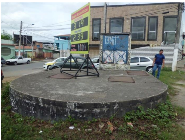
Figura 18: Estação elevatória Vale Encantado
