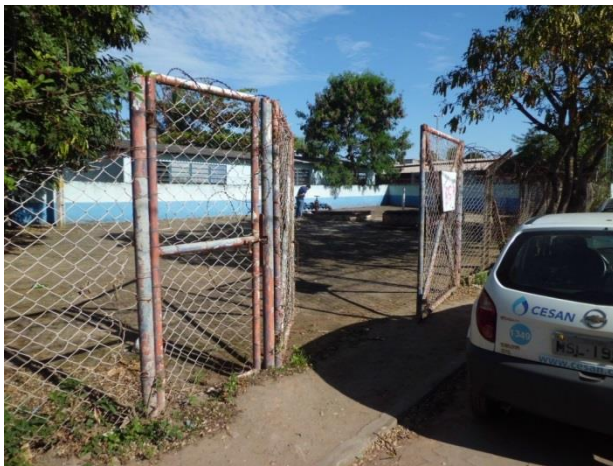
Figura 16: Estação elevatória Terra Vermelha I
