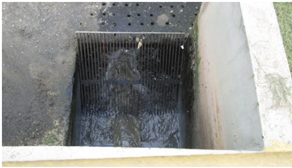
Figura 38: Tratamento preliminar - gradeamento
