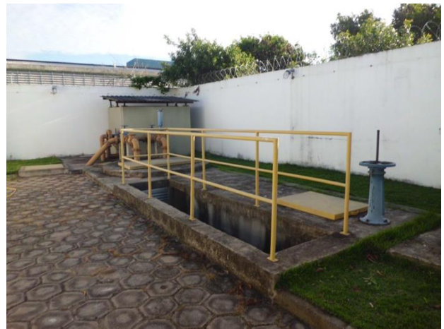
Figura 5: Estação elevatória EEEB-1
