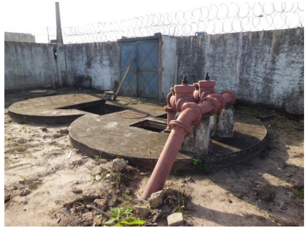
Figura 11: Estação elevatória Jabaeté I
