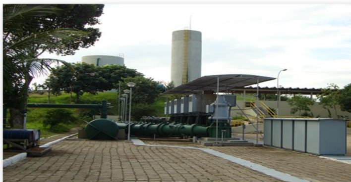
Figura 26 - Estação Elevatória de Água Bruta – Baixo Recalque.
