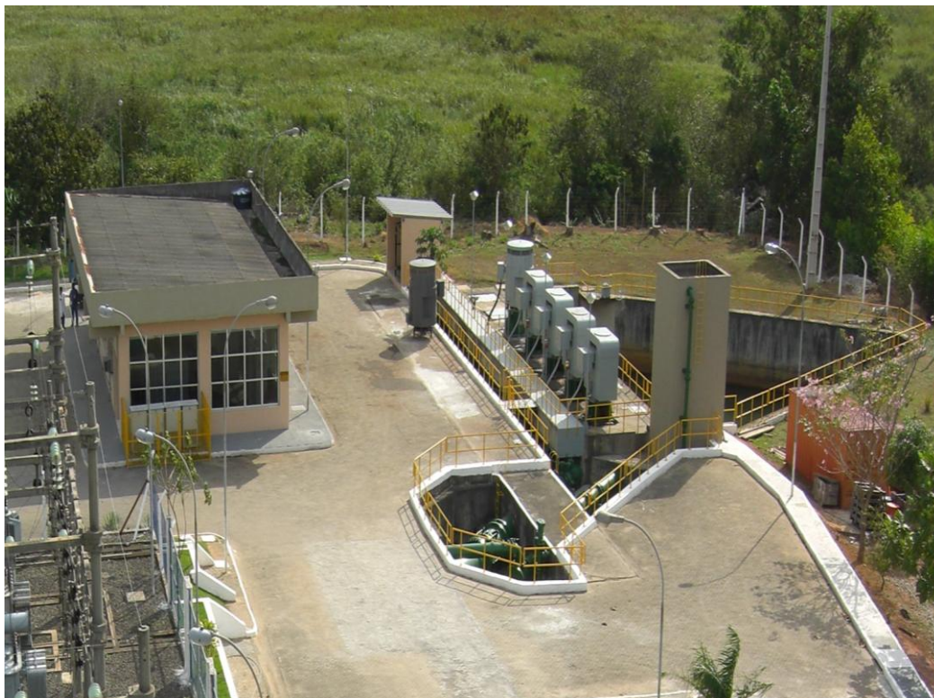
Figura 33 - Estação Elevatória de Água Bruta
