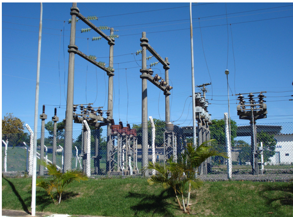
Fotos 1 e 2 – Vista Geral da Subestação
