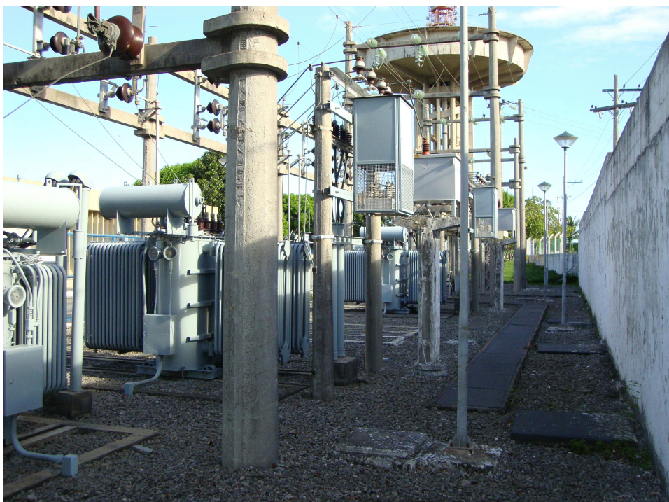
Fotos 3 e 4 – Superfícies de concreto necessitando de pintura geral para proteção contra intempéries
