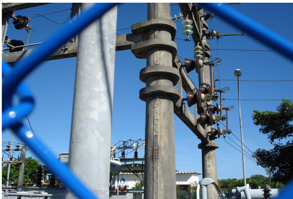
Fotos 5 e 6 – Estruturas necessitando de recomposição de cobrimentos de concreto
