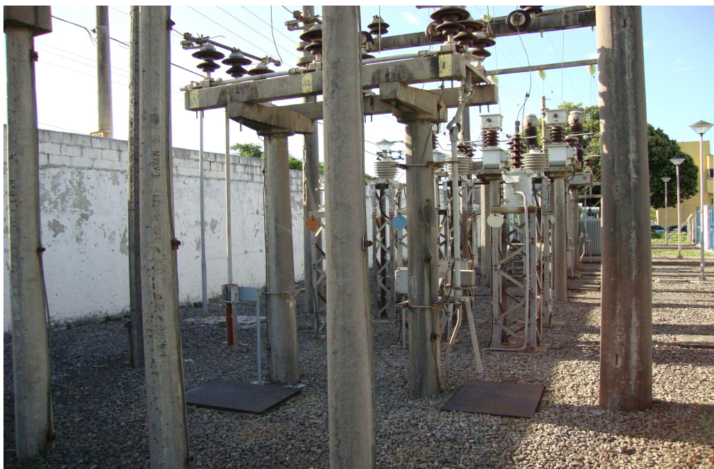
Fotos 5 e 6 – Estruturas necessitando de proteção das armaduras e recomposição de cobrimentos de concreto
