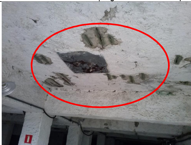
Figura 10 – detalhe de corrosão pontual da armadura
