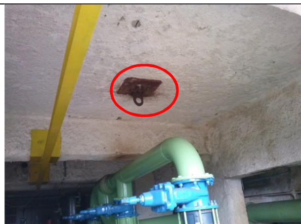
Figura 9 – detalhe 2ª placa metálica fixada ao teto
