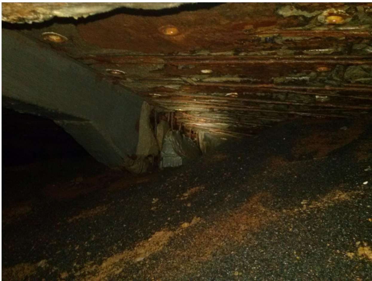
Figura 4 – concreto e armaduras comprometidos
