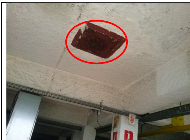
Figura 8 – detalhe 1ª placa metálica fixada ao teto
