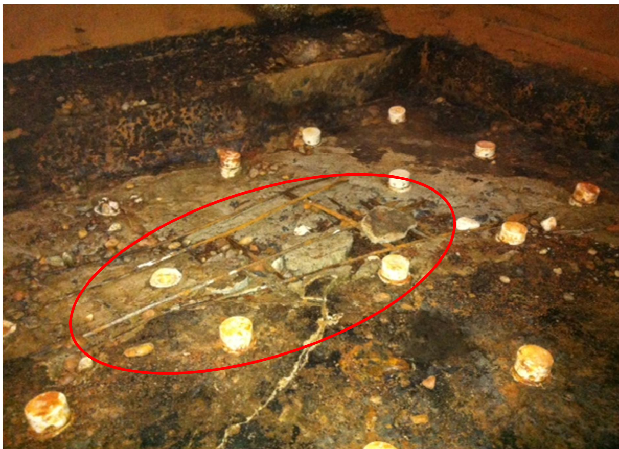
Figura 2 – deterioração generalizada do concreto de cobrimento e da armadura de aço.
