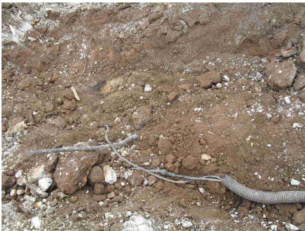
Visão do cabo rompido no leito de ânodos danificado no Retificador R1
