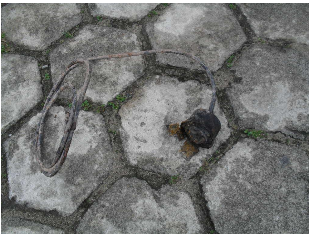
Visão do ânodo rompido no leito de ânodos danificado no Retificador R1
