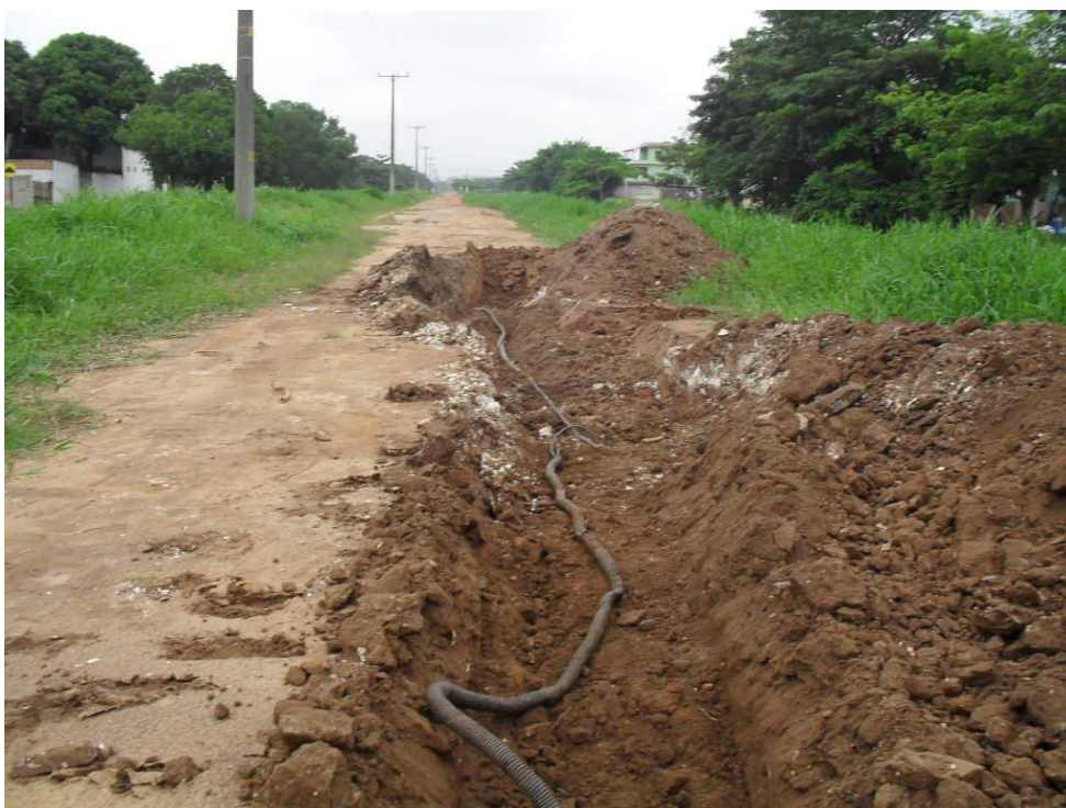
Visão do leito de ânodos danificado no Retificador R1
