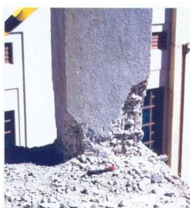
Vazio de concretagem
