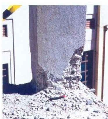
Vazio de concretagem
