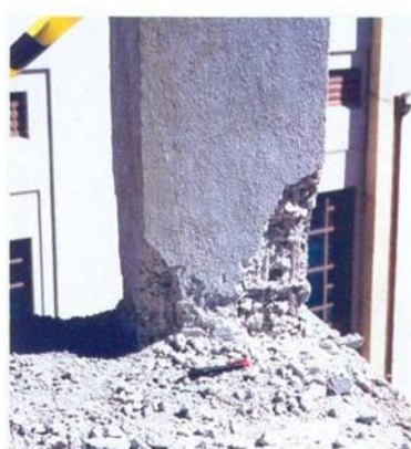
Vazio de concretagem
