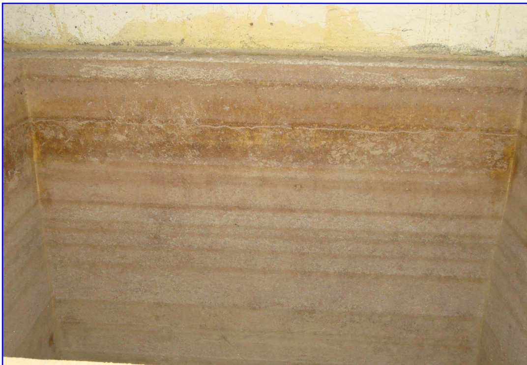
Foto 4 – Condição atual das paredes dos tanques em concreto armado que armazenam sulfato de alumínio – Eta Vale Esperança
