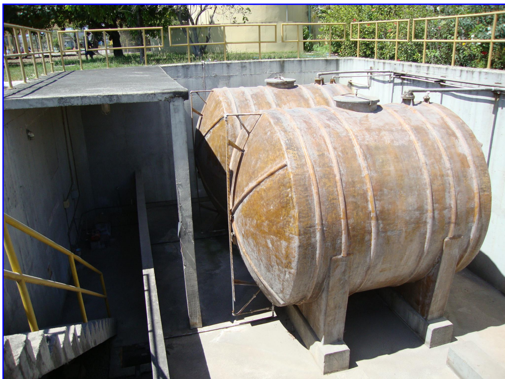
Foto 8 – Manutenção corretiva e preventiva nos tanques em fibra de vidro que armazenam ácido fluorsilícico (2 unidades) – Eta V
