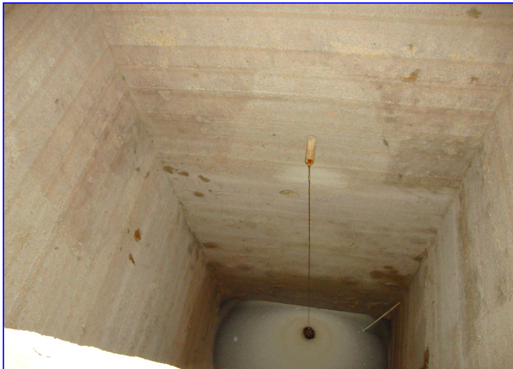
Foto 5 – Condição atual das paredes dos tanques em concreto armado que armazenam sulfato de alumínio – Eta Vale Esperança
