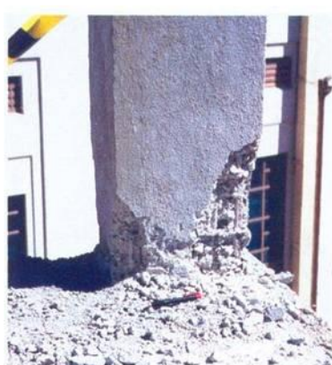
Vazio de concretagem
