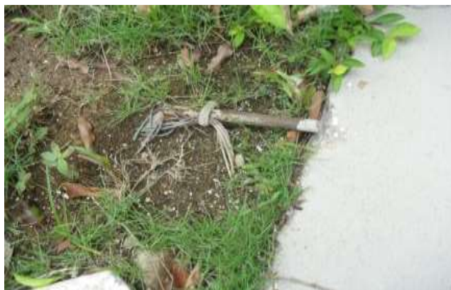
Figura 0.4 – Ponto de interligação inadequado das malhas do SPDA
