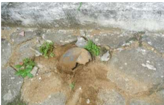
Figura 0.5 – Caixa de inspeção inadequada do SPDA
