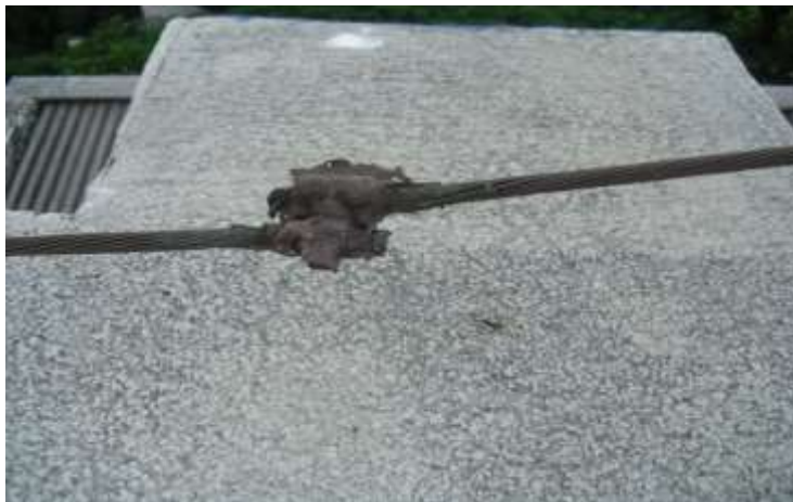
Figura 0.2 - Ponto de solda no Subsistema de captação do SPDA
