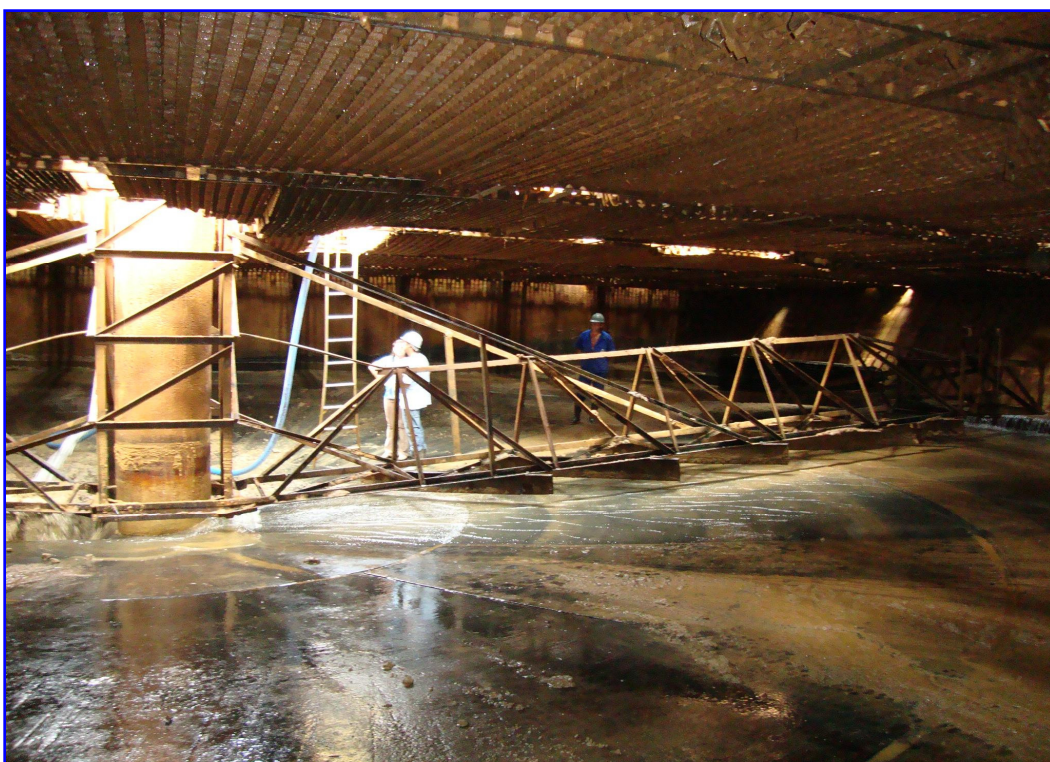
Fotos 9 e 10 – Estruturas de aço que compõem o removedor de lodo necessitando de tratamento e pintura contra corrosão
