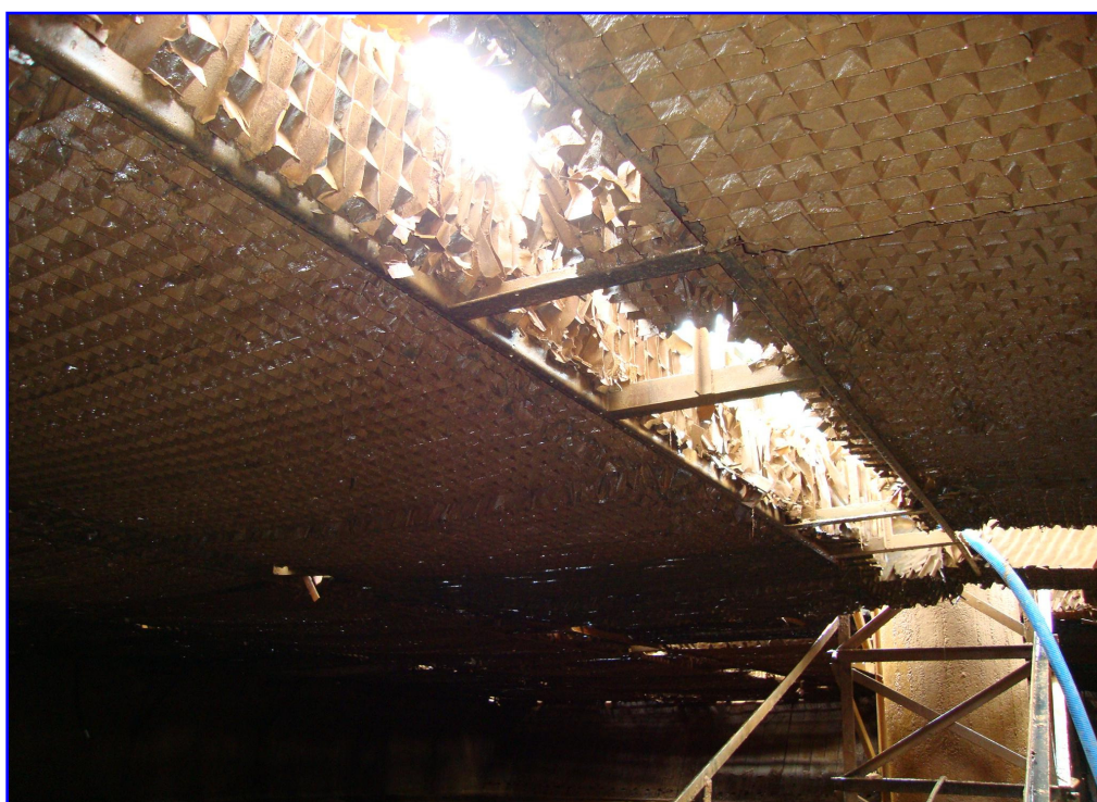
Fotos 5 e 6 – Estruturas metálicas de suporte das colméias dos decantadores precisando de tratamento e pintura contra corrosão. Além disso, necessidade de inclusão de vigas intermediárias (treliçadas) entre os vãos das colméias.
