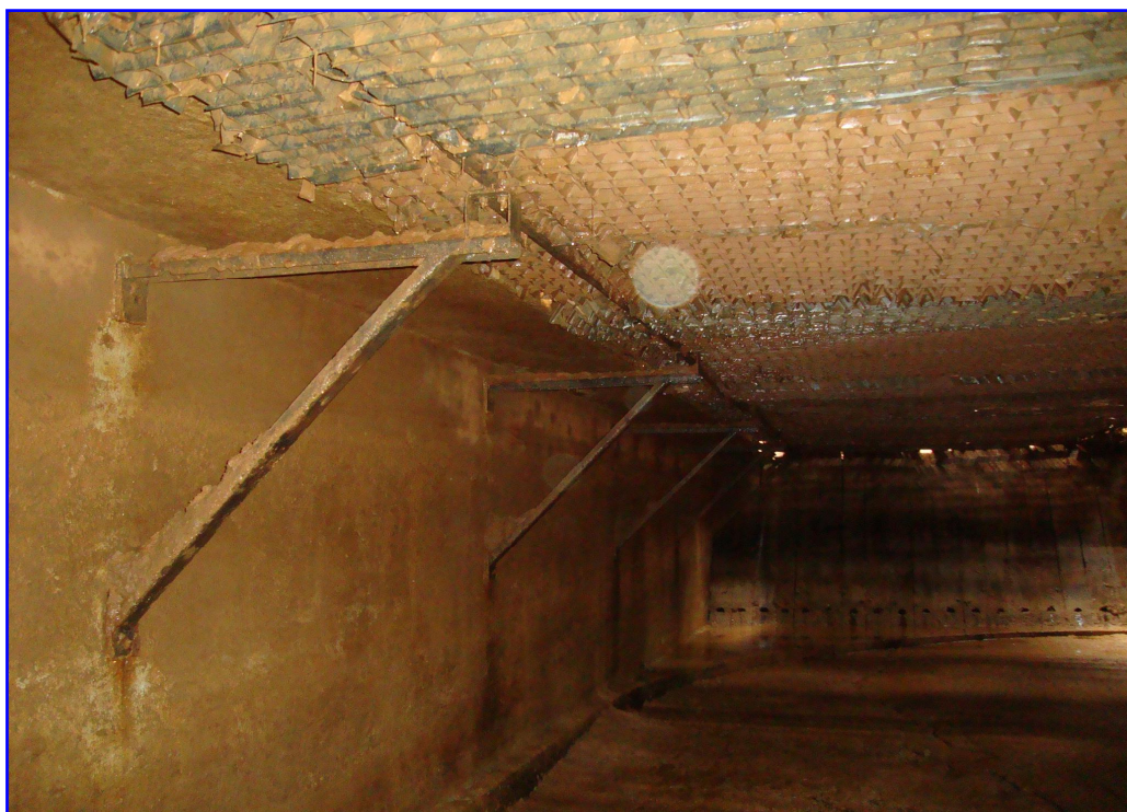
Fotos 7 e 8 – Necessidade de substituição das Mãos francesas de aço que apoiam as extremidades das colméias dos decantadores, devido ao elevado estado de corrosão das peças existentes
