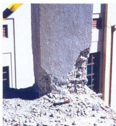
Vazio de concretagem
