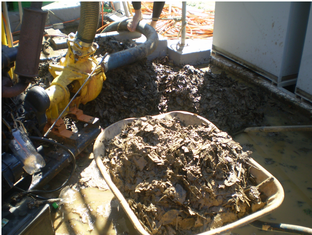
Fig. 10 Detritos sólidos removidos dos poços de sucção das bombas
