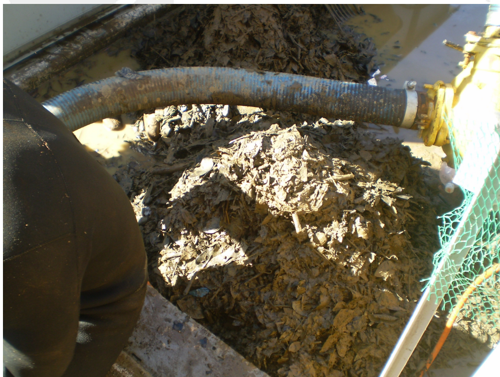
Fig. 9 Detritos removidos dos poços de sucção das bombas
