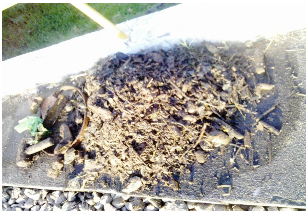
Material retirado embaixo da bomba.
