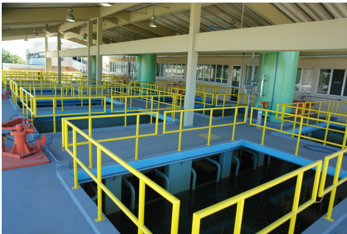
FIGURA 6: ETA V - VISTA GERAL DOS FILTROS RÁPIDOS, SOBRE OS QUAIS FORAM POSICIONADOS OS EQUIPAMENTOS DE FLOTAÇÃO.
