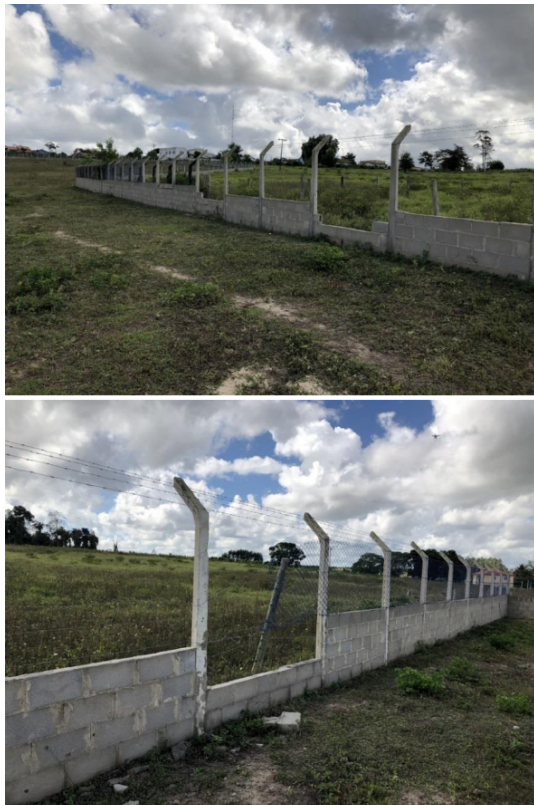
Figura 4 – Condições da cerca da ETE existente.
