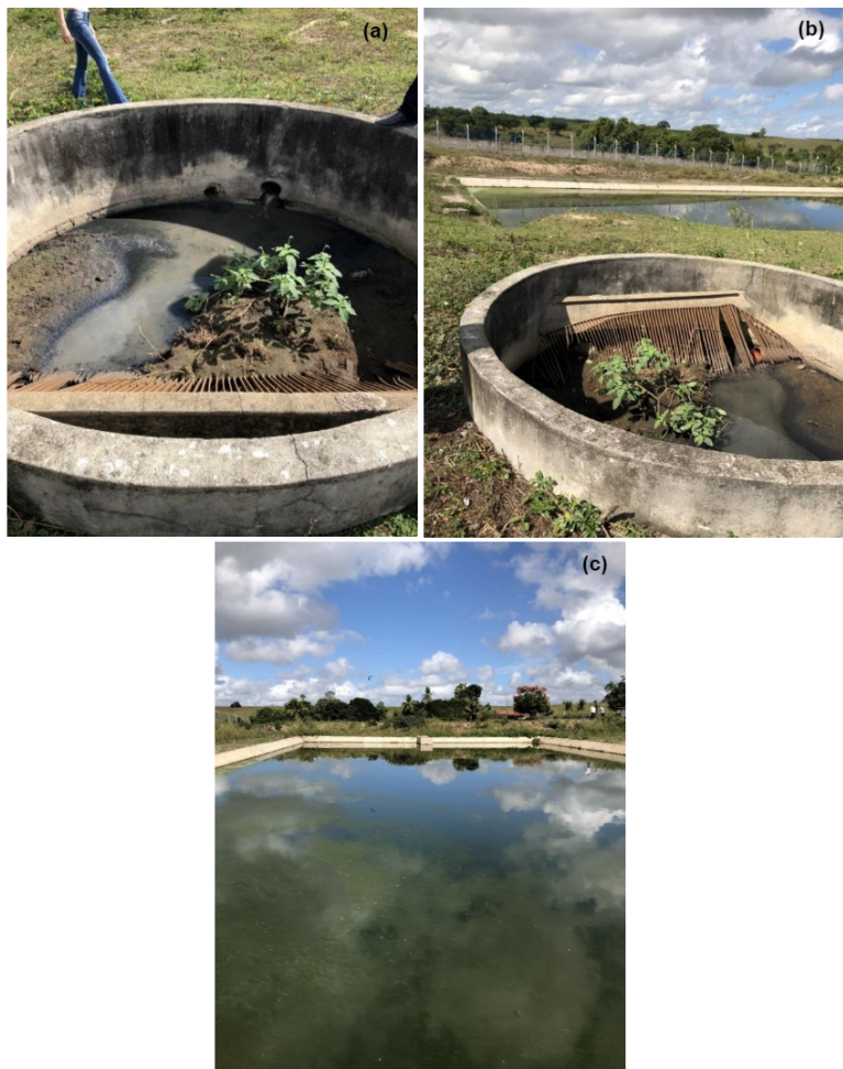
Figura 5 – Vistas (a) do gradeamento existente, (b) do gradeamento e da lagoa facultativa desativada, e (c) lagoa facultativa desativada.
