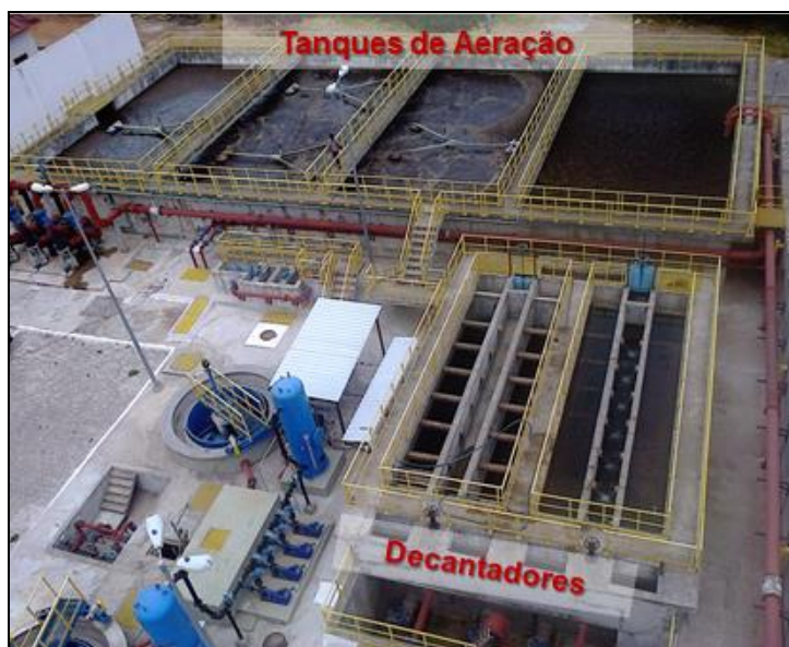
Figura 10: Visão geral do tratamento secundário.
